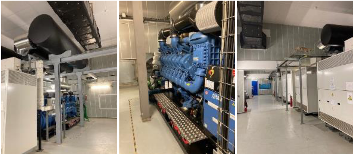
Figure 14 : Groupes électrogènes présents dans le bâtiment U
