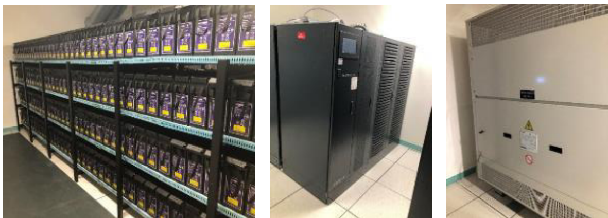
Figure 11 : Photographie d'une salle batterie, d'un onduleur et d'un transformateur
